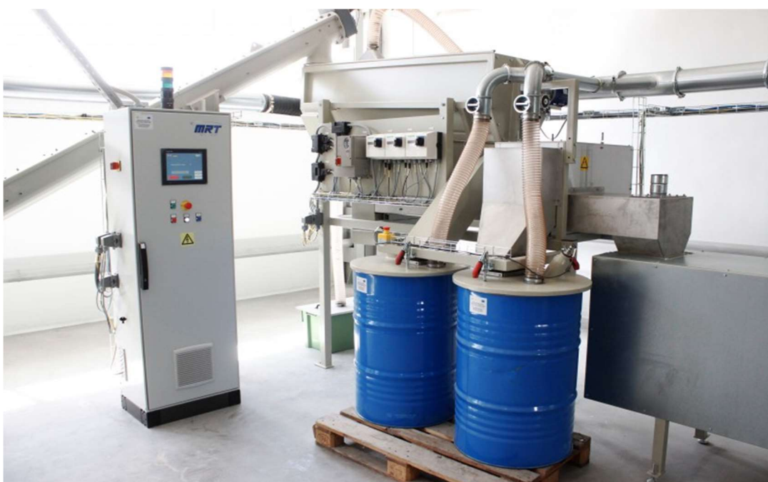
Rysunek 9.3. Dostawcą urządzeń do linii przetwarzania odpadów zawierających rtęć w "Bodnarówce" jest szwedzka firma "MRTSystemAB"
